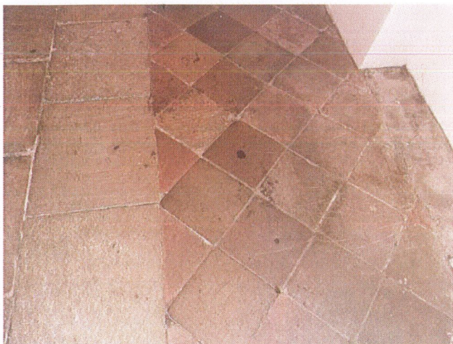
Brakujący fragment posadzki z piaskowca uzupełniony zaprawą cementową
