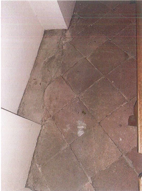
Brakujący fragment posadzki z piaskowca uzupełniony zaprawą cementową
