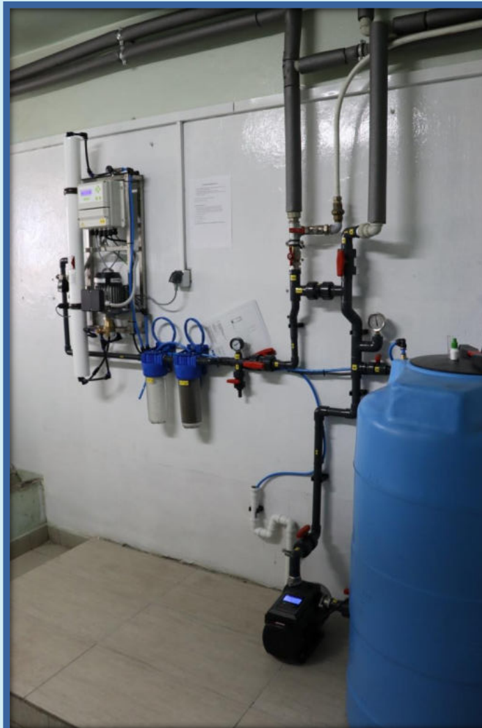
System uzdatniania wody
